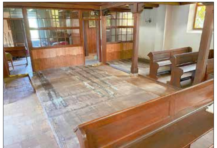
Ausgebaute Bänke und Schimmelbildung Bild: Bärbel Spieker
