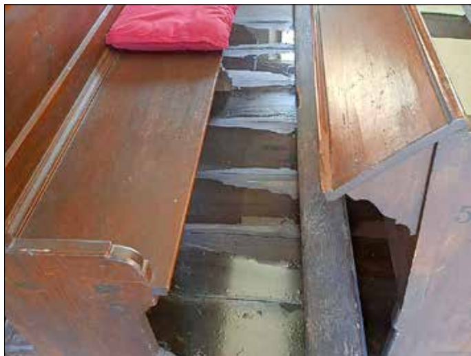
Pfützen im Kirchenraum in der Kirche in Rehse Bild: Bärbel Spieker
